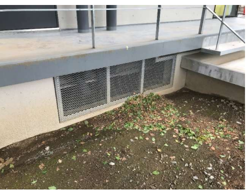
外気取入口（外部側）
