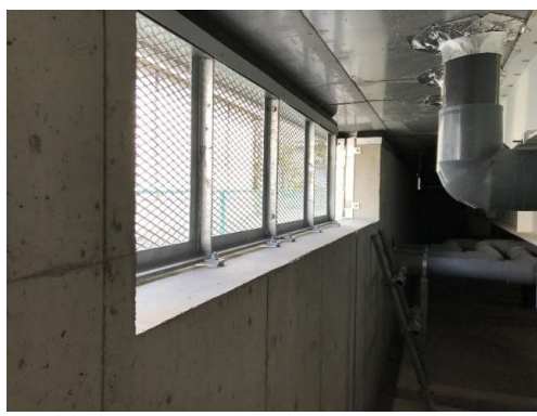
外気取入口（ピット側）
