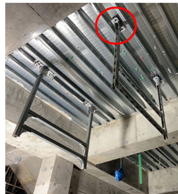
設備共通架台
