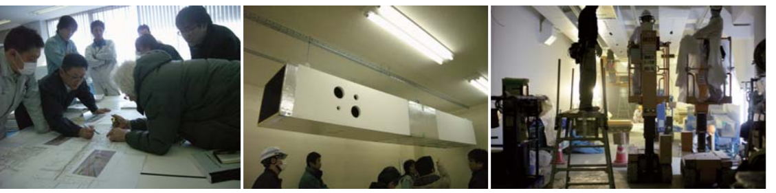
空調ダクトにおける検討(モックアップ等)から施工までの様子
