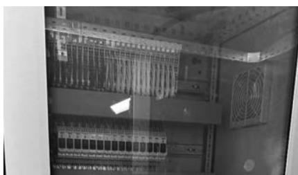
写真-6 制御盤内
