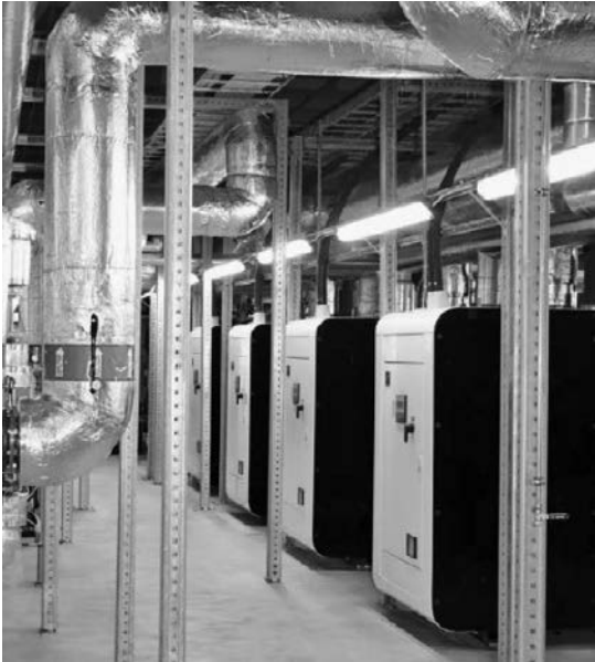
写真-3 地中熱利用ヒートポンプ
