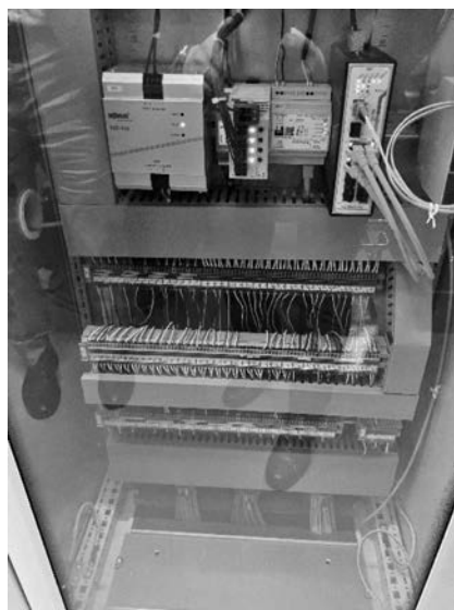
写真-7 制御盤内
