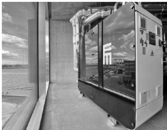
写真－7 外から見えるヒートポンプ
