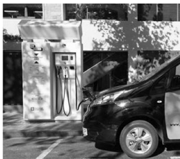
写真-5 電動自動車用充電器
