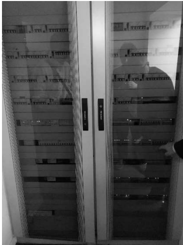
写真-7 システム制御盤
